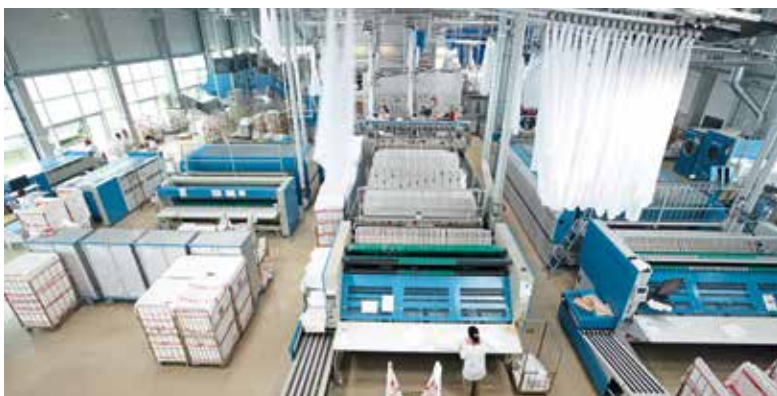
Im Jahr 2007 ist die Wäscherei innerhalb von Bruckmühl in ein neues, größeres Gebäude umgezogen. Das Resultat: Dreimal so viel Produktionsleistung.
